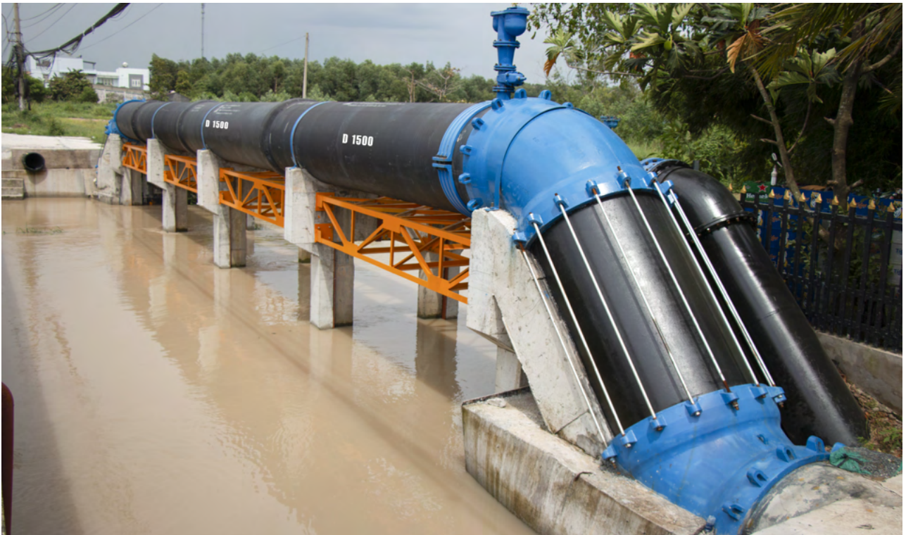
THI CÔNG ỐNG NƯỚC THÔ D1500mm QUA SÔNG, RẠCH CONSTRUCTING D1500mm RAW WATER PIPELINE CROSSING RIVER AND CANAL
