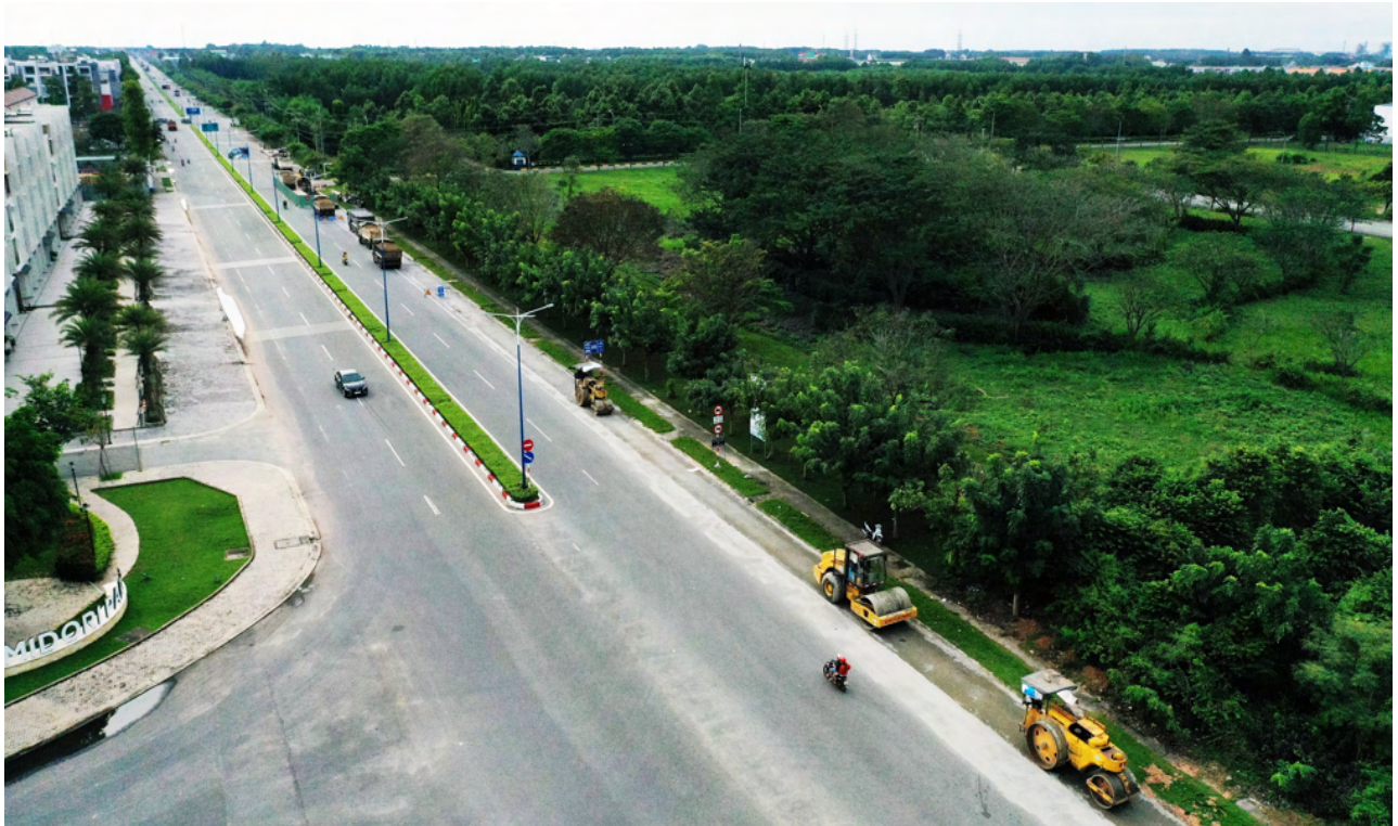
THI CÔNG HOÀN TRẢ MẶT ĐƯỜNG GIAO THÔNG ROAD SURFACE RESTORATION CONSTRUCTION
