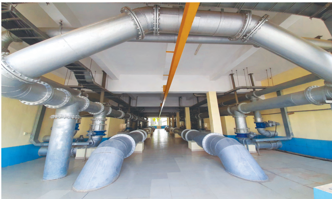
THI CÔNG LẮP ĐẶT ỐNG CÔNG NGHỆ CONSTRUCTION AND INSTALLATION OF TECHNOLOGY PIPELINE
