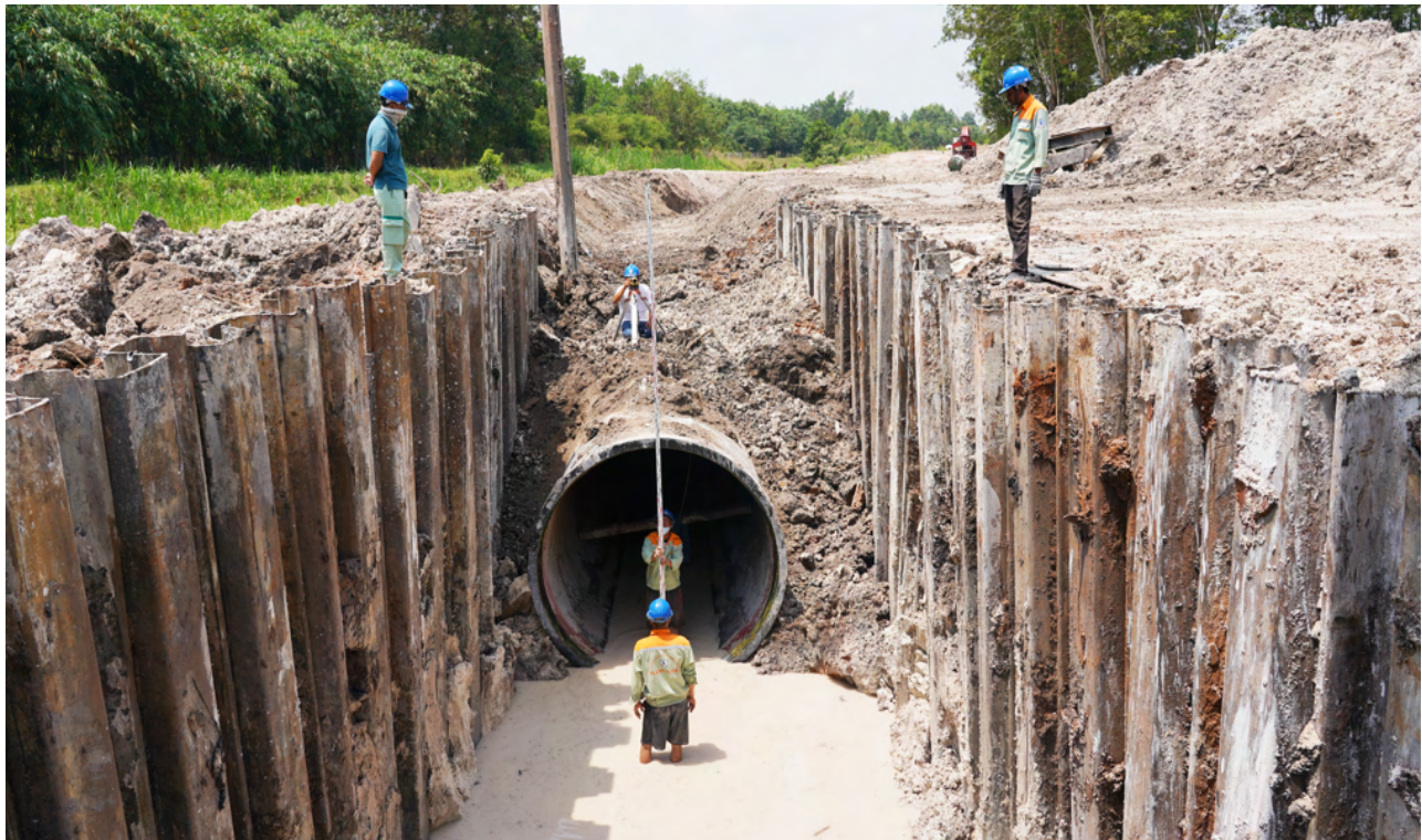
THI CÔNG LẮP ĐẶT TUYẾN ỐNG CẤP NƯỚC THÔ ĐƯỜNG KÍNH 2400mm CONSTRUCTION AND INSTALLATION OF RAW WATER SUPPLY PIPELINE WITH A DIAMETER OF 2400mm
